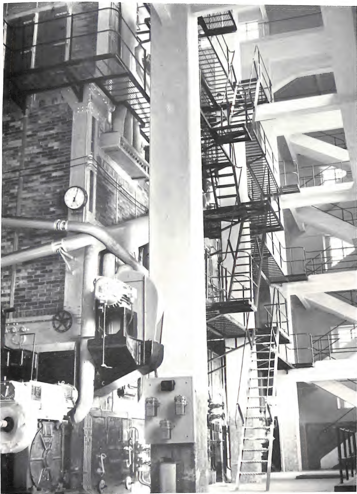
Centrale di Porto Vesme - Caldaia da 700 mq.
